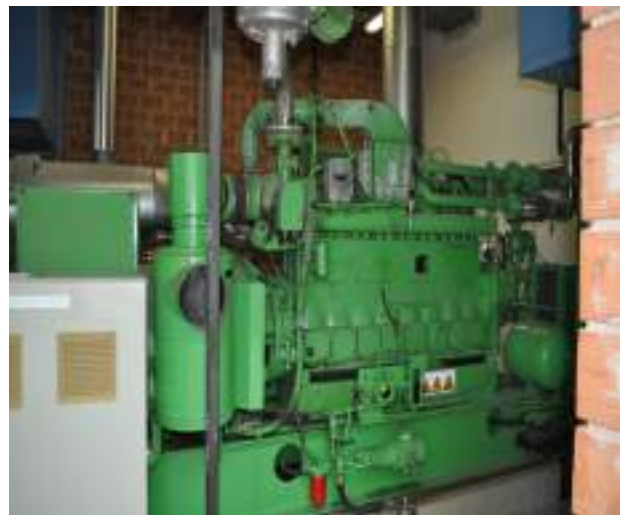
5. ábra Szennyvíziszap biogázából villamos energiát termelő gázmotor
